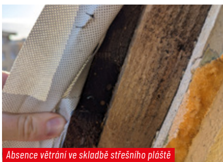
Bytový dům, na jehož střeše zhotovitel udělal řadu chyb
