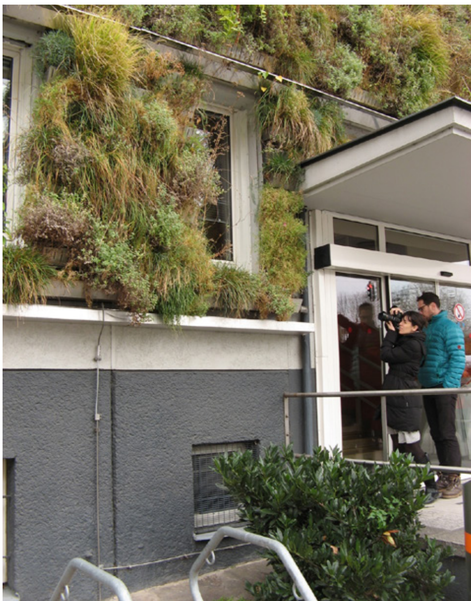
3) Zelená fasáda založená systémem před-sazených vegetačních kontejnerů na budově MA 48 (archiv autora)
